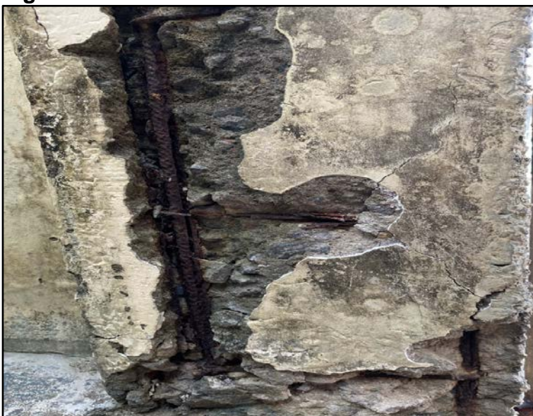
Figura 3 – Corrosão de armaduras
