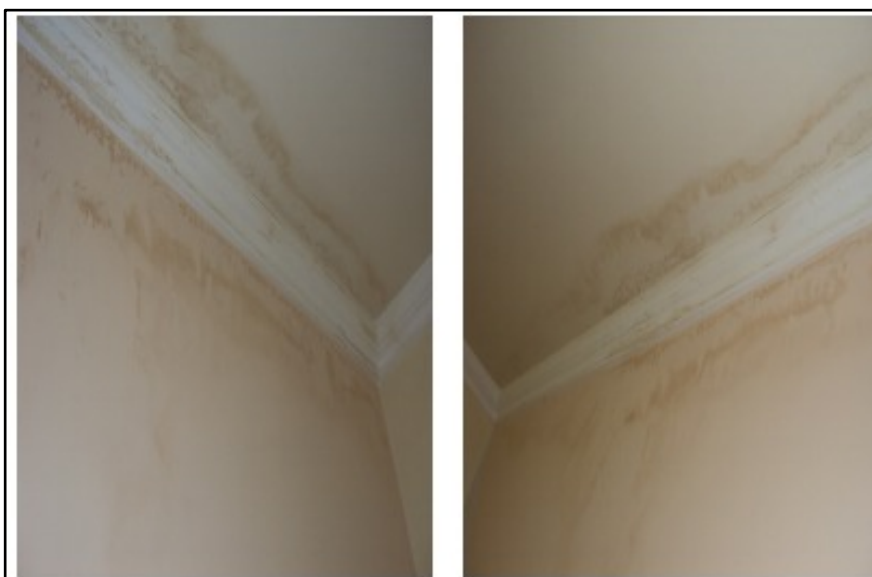
Figura 5: Umidade resultante de infiltração.
