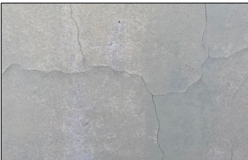
Figura 1: Trincas e fissuras
